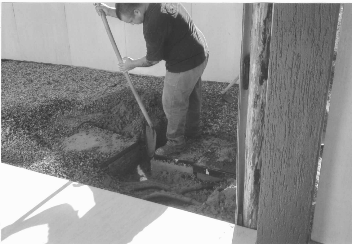
Escavação para completar mais ou menos 6 metros de cano pvc que faltaram do apartamento 23 até a fossa e funcionário sem o uso do EPI. Fotografado em 13/02/2013.
