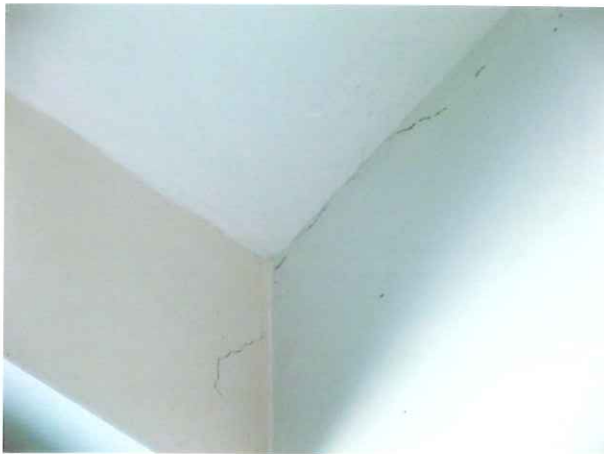
FOTO 07 Descolamento entre a parede e a laje;
