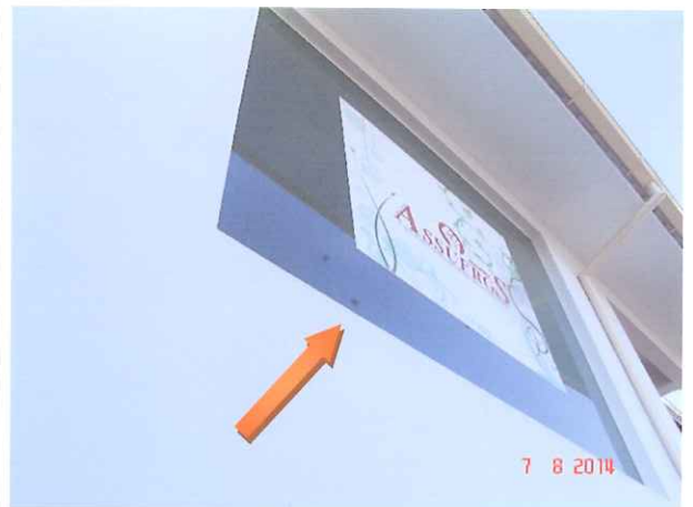
FOTO 10 Vidraçaria sem peitoril e/ou pingadeira apresenta escorrimento na pintura;
