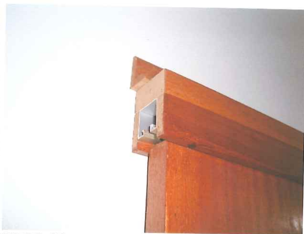
FOTO 17 Falta de terminal ou batente permite danos na fechadura – vários apartamentos;
