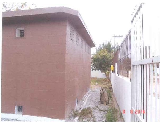
FOTO 43 Fundos da Central de gás;
