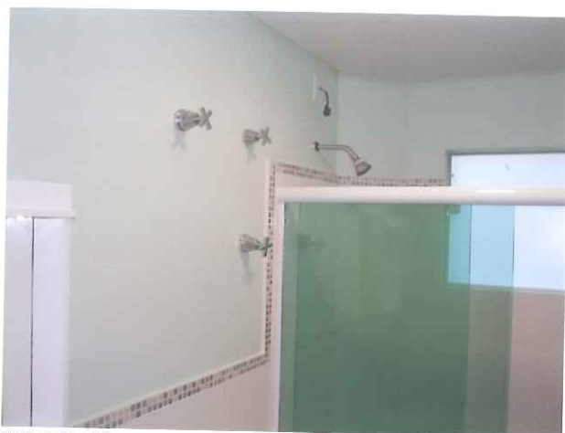
FOTO 13 Assentamento irregular apresentando quinas vivas – em todos apartamentos;
