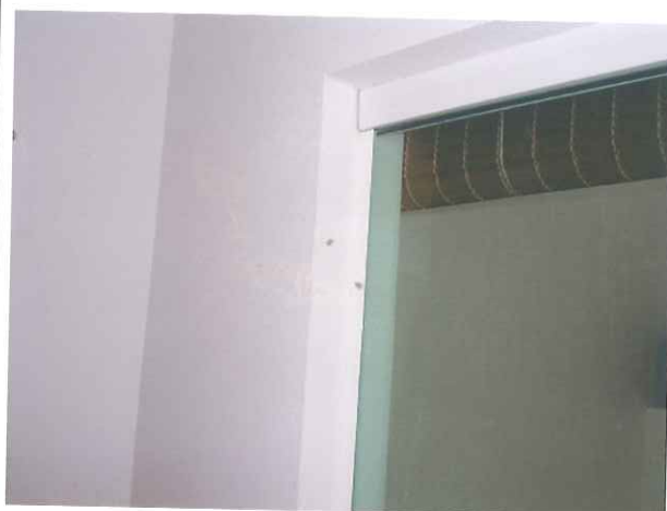
FOTO 22 Rachadura na alvenaria ao lado da janela dos fundos, no apto. 32;
