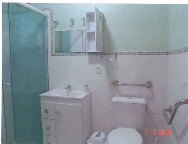
FOTO 47 Barras de apoio somente ao lado do vaso sanitário. Mobiliário fora de norma;
