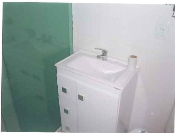
FOTO 37 Pias e armários soltos com possibilidade de vazamentos – todos apartamentos;
