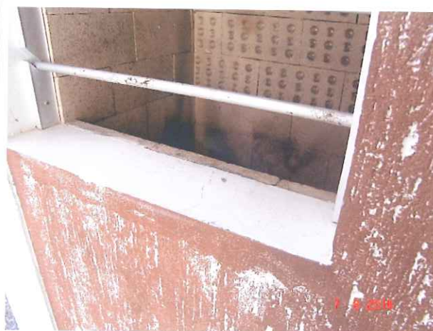
FOTO 28 Rachadura na alvenaria da churrasqueira – vários apartamentos;
