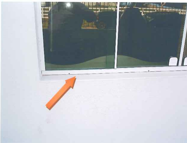
FOTO 11 Janelas sem peitoril e/ou proteção apresenta infiltração, no apto. 25;
