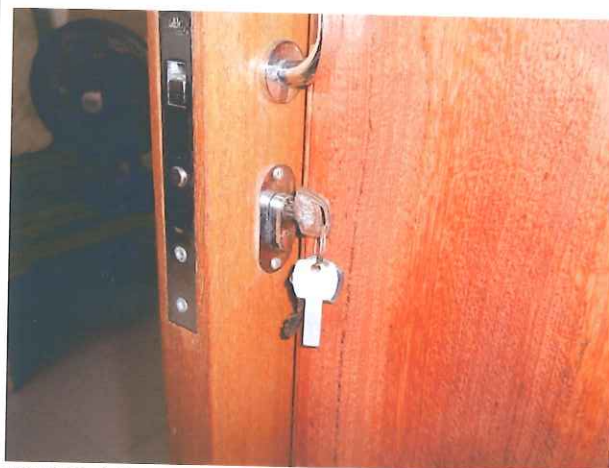
FOTO 16 Possibilidade de quebra da chave e/ou fechadura – vários apartamentos;
