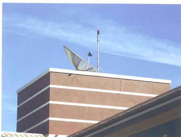
FOTO 35 Antena em local inadequado;
