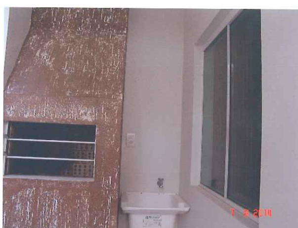
FOTO 36 Falta de registro para os tanques dos apartamentos, no andar térreo;
