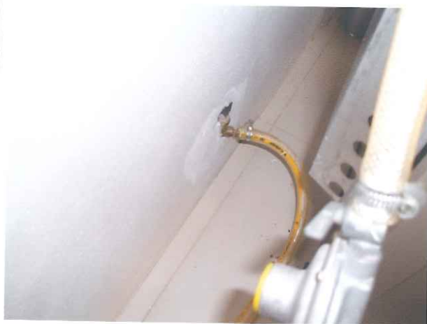
FOTO 41 Instalação de gás, sem critério e cuidados – vários apartamentos;
