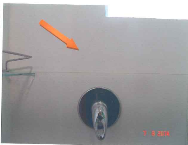
FOTO 15 Rachadura no revestimento cerâmico do banheiro, no apto. 20;
