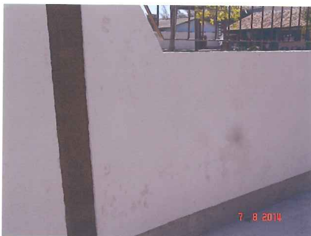
FOTO 45 Pintura do muro apresenta falhas e trechos descascados;
