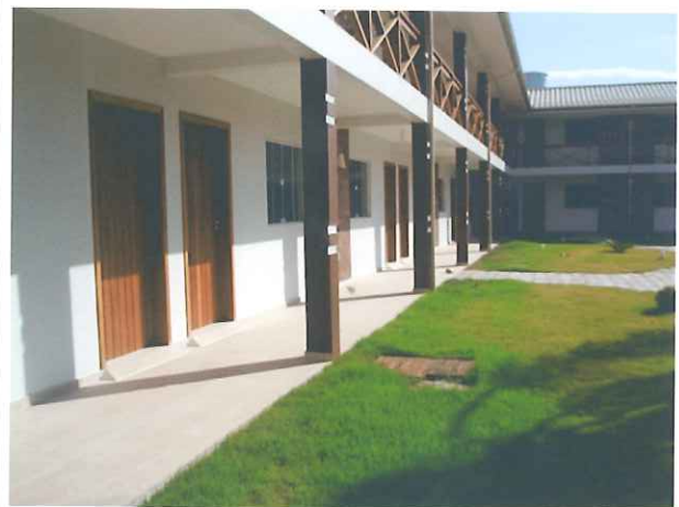
FOTO 46 Diferença de nível entre os módulos apresenta degraus e rampas fora de norma;
