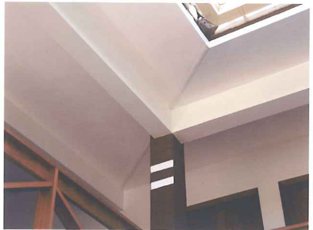
FOTO 08 Acabamento no encontro das lajes de forro;
