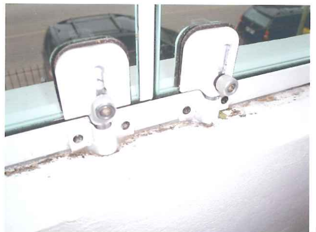
FOTO 12 Janelas sem peitoril e/ou proteção apresenta infiltração, no apto. 25;
