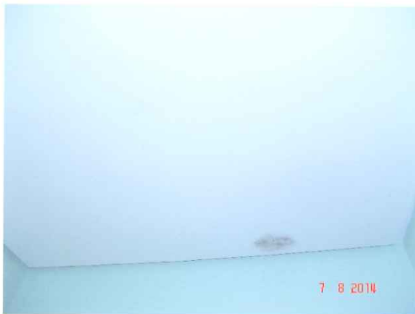
FOTO 09 Infiltração aparente no forro de gesso, no apto. 20;
