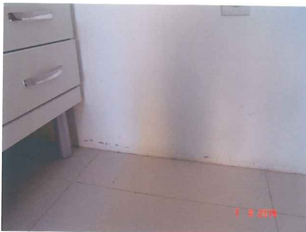
FOTO 27 Descolamento do revestimento da base na cozinha, no apto. 23;
