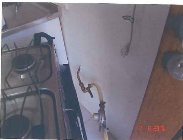
FOTO 39 Instalação de gás, sem critério e cuidados – vários apartamentos;
