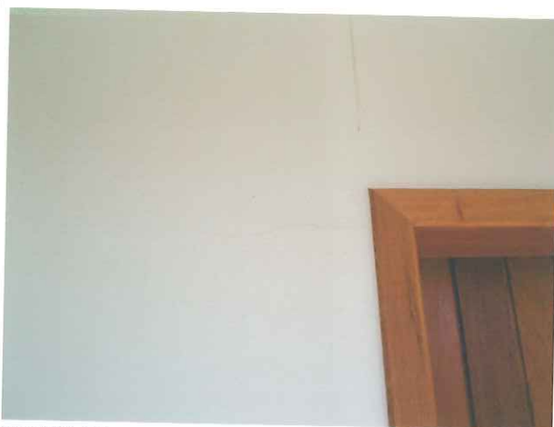
FOTO 21 Rachadura na alvenaria ao lado da porta da frente, no apto. 33;
