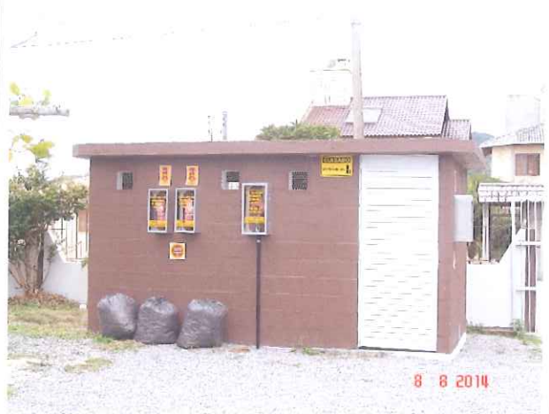
FOTO 44 Frente da Central de gás;
