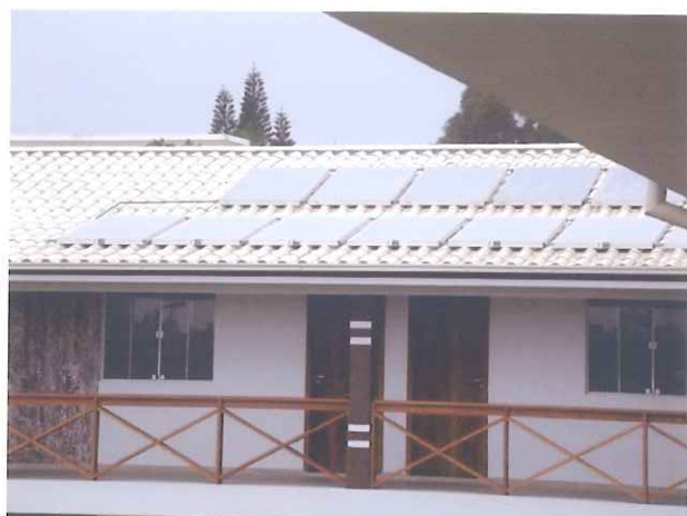
FOTO 31 Sistema de aquecimento solar – Incremento das placas;
