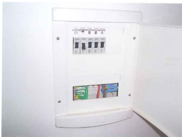
FOTO 33 Quadros Elétricos, fiação acessível – vários apartamentos;
