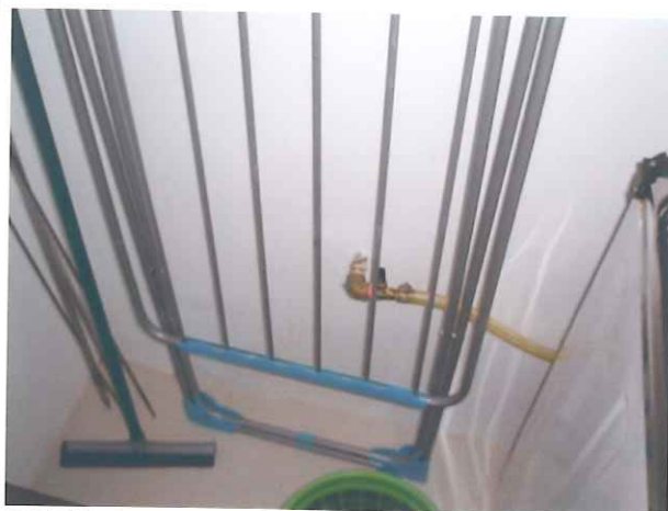
FOTO 40 Instalação de gás, sem critério e cuidados – vários apartamentos;
