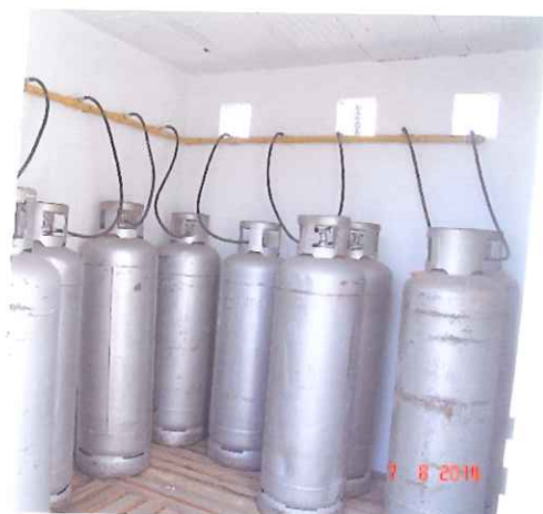
FOTO 42 Central de gás, bateria do lado direito;
