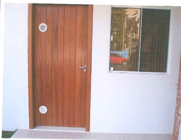
FOTO 18 Furos nas portas das varandas ao invés de ser nas portas da cozinha – todos apartamentos;
