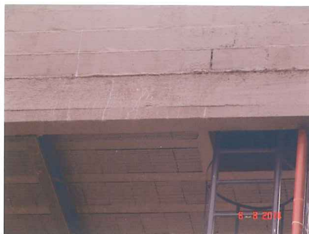
FOTO 02 Descolamento da alvenaria com a estrutura;
