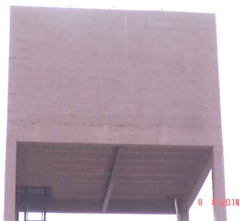
FOTO 01 Descolamento da alvenaria com a estrutura;
